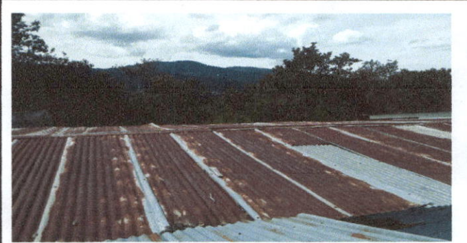
Foto 6: lámina con muchas goteras
