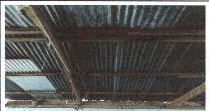
Foto 4: estructura de madera agrietada
