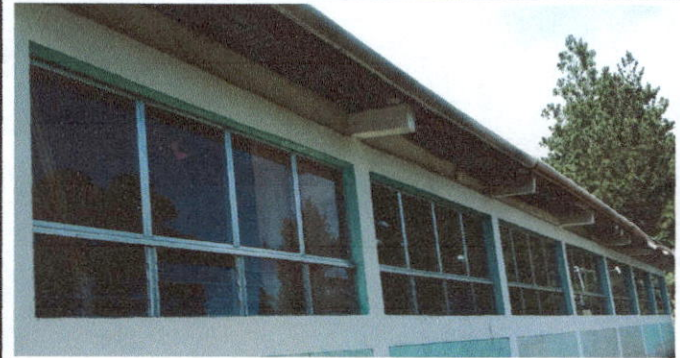
Foto 2: parte de atrás de la escuela con falta de balcones
