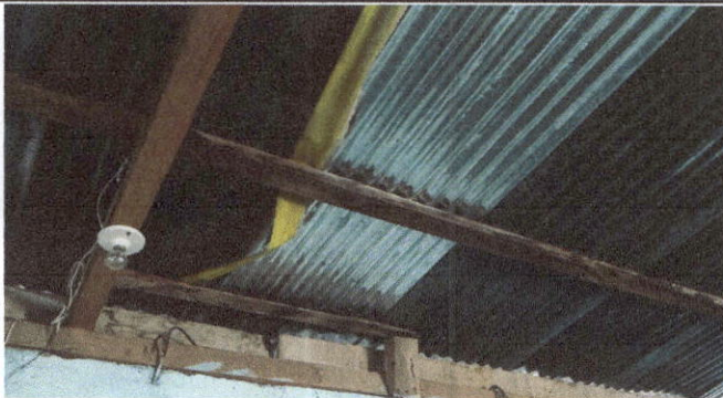
Foto 3: estructura de madera en mal estado
